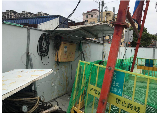
图4 施工现场电箱
