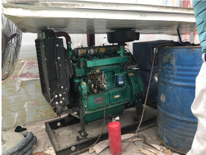
图3 施工现场的柴油发电机
