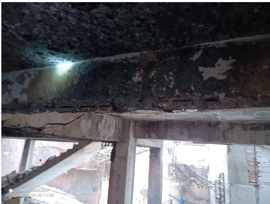
图3 发胶作坊屋顶南北主梁、顶面开裂情况
