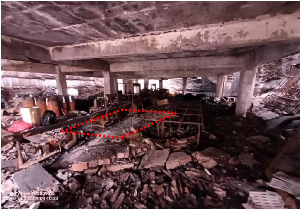
图 1 七星岗路 40 号二楼事发现场(自北向南视角，虚线区域为爆燃核心区域)
