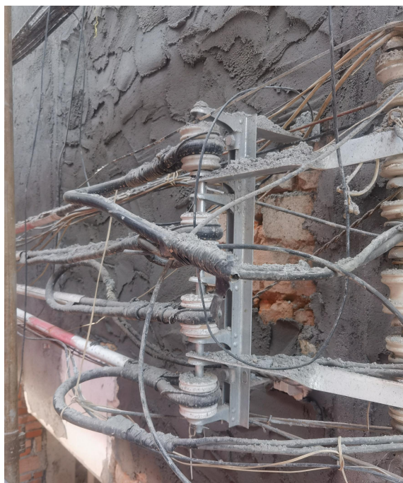
图 17 街码尾端线路情况
