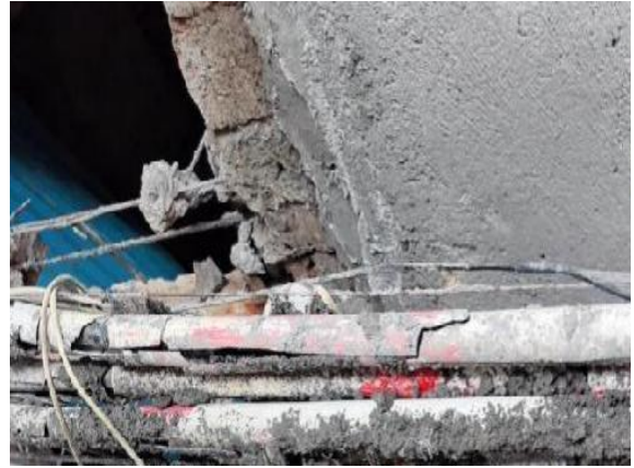
图13 套管破损，水泥附着在电力设施表面
