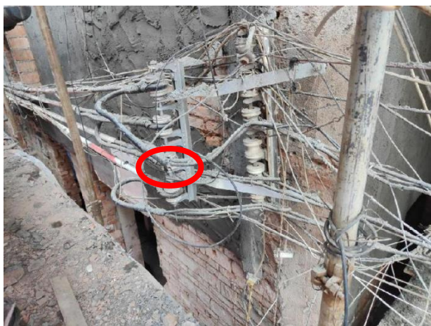
图 23 绝缘破损带电点
