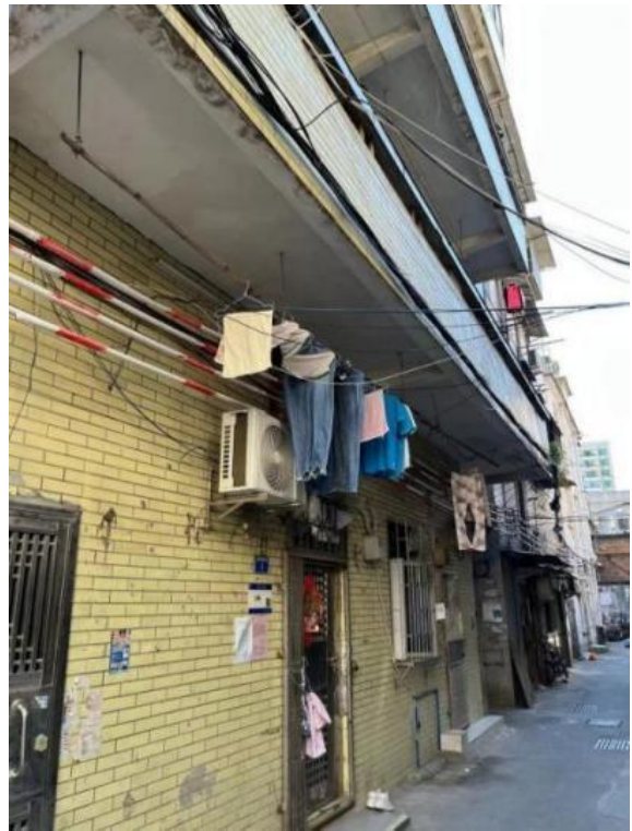
图 33 事发路段低压线路修缮后情况
