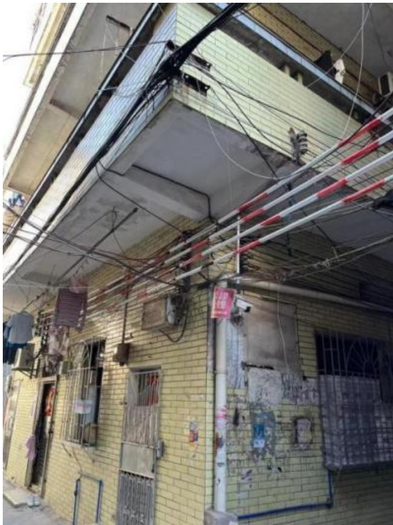
图 32 事发路段低压线路修缮后情况
