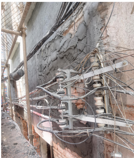
图 8 电线及墙面情况
