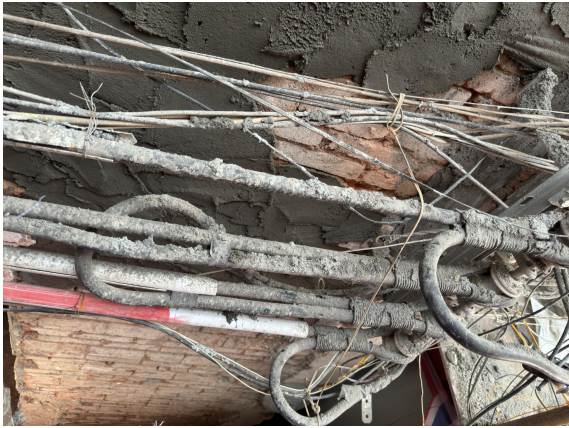
图12 套管破损，水泥附着在电力设施表面
